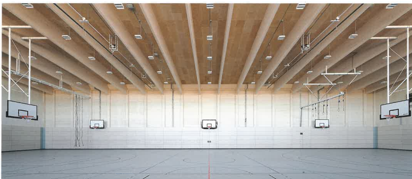
Bild 9. Die HWL-Platten sind ballwurfsicher und deshalb auch für die Sporthalle der Schule geeignet (Fotos: Thomas Mayer, Neuss)
