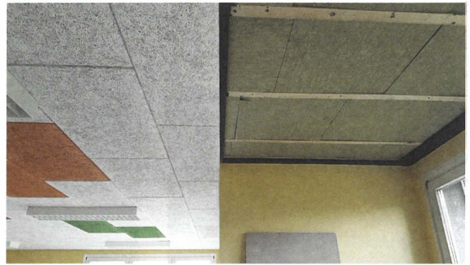
Bild 2 Rechts: Mit Mineralwolle gefüllte Zwischenräume der vorhandenen Holzunterkonstruktion als zusätzliche Schalldämmung. Links: Fertig montierte Fibro-Kustik Platten.
