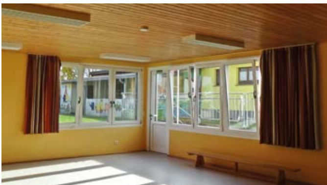
Mehrzweckraum des Kindergartens vor der Deckensanierung.
